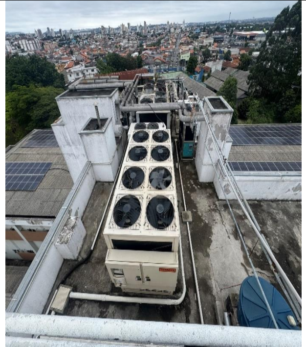
Vista superior – Área técnica
