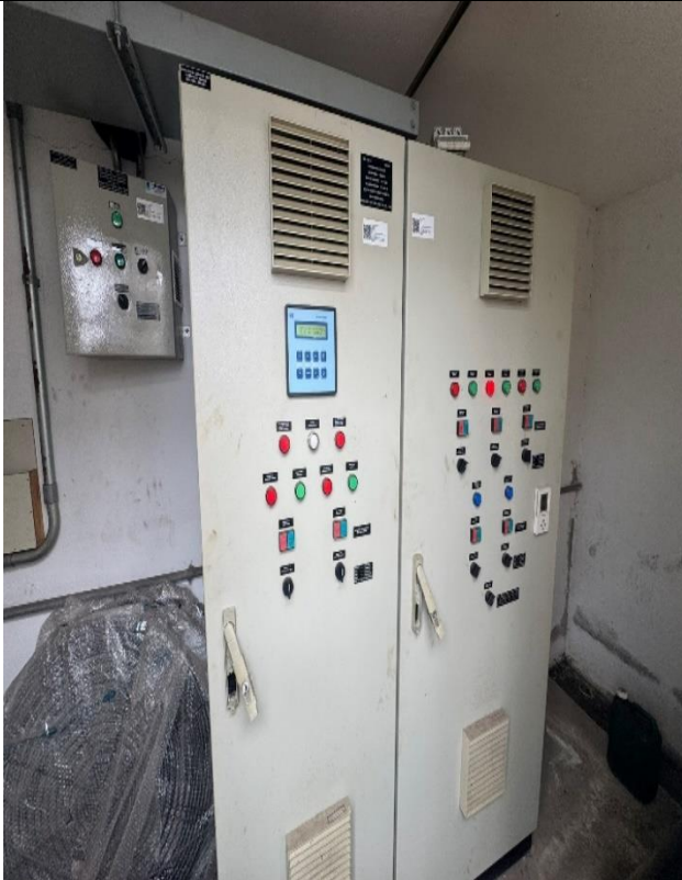
Painel de comando Chiller/Bombas
