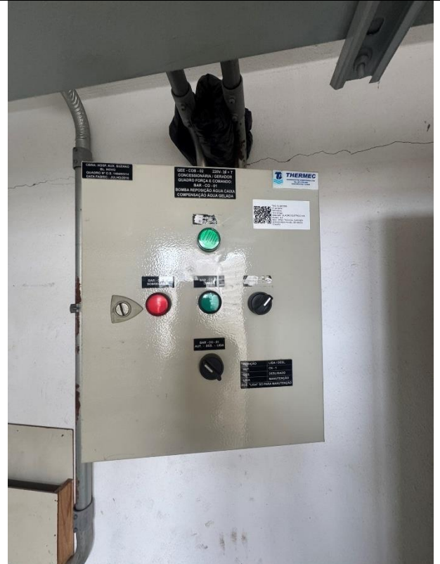
Painel de comando Chiller/Bombas
