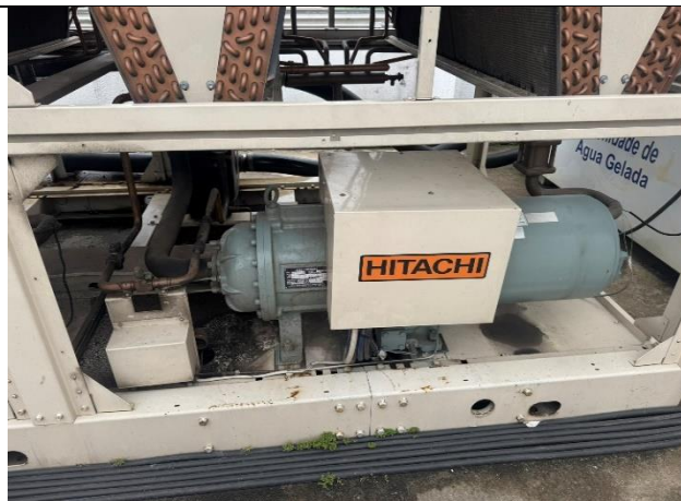
Compressor 02 – Em operação
