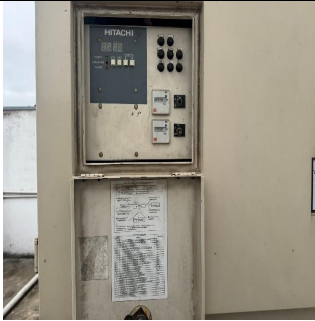
Painel de comando - Chiller
