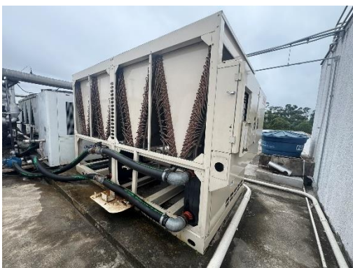
Fig - Chiller locado em operação (Hitachi)
