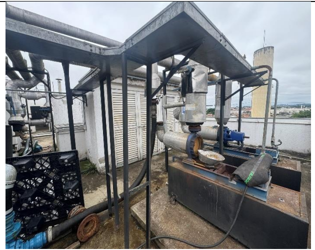
Bomba de água – Chiller 02 desativado
