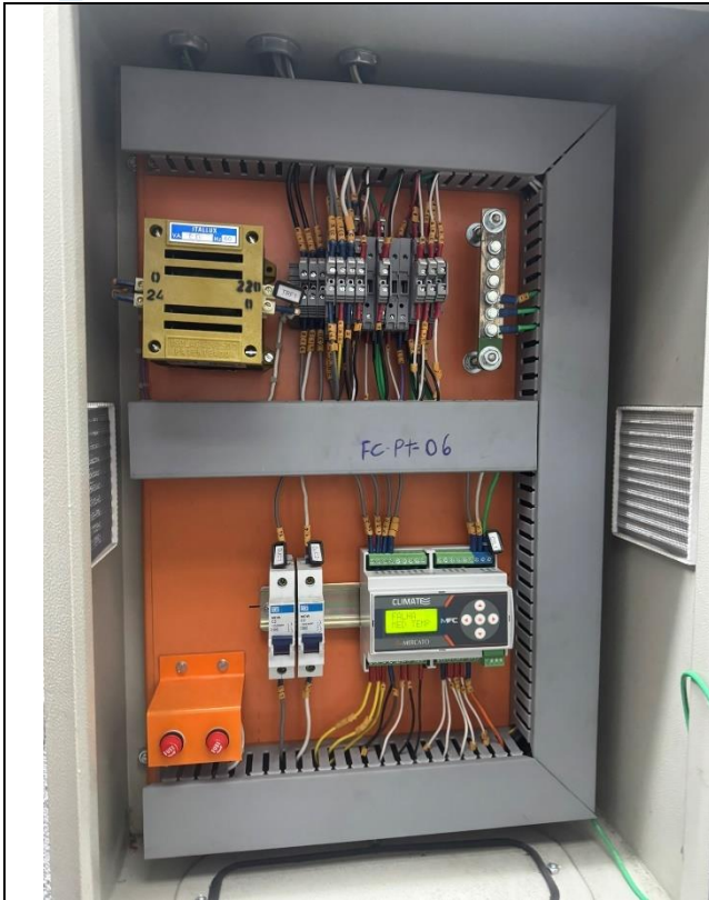
Painel de comando - Fan Coil
