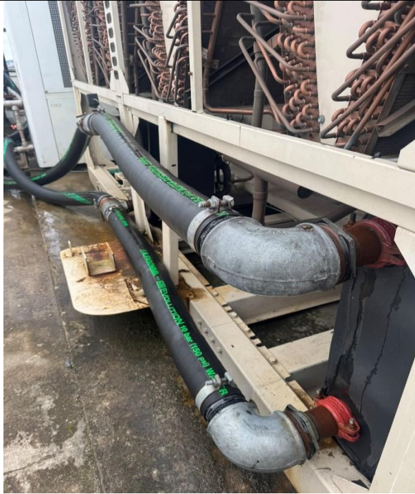
Entrada e Saída de água
