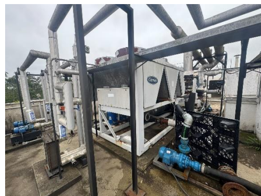
Fig - Chiller desativado (Carrier)
