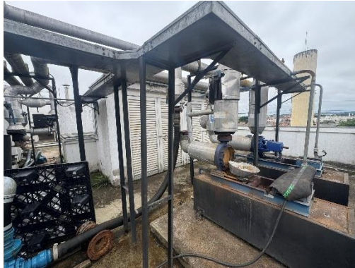
Fig - Sistema de bombeamento de água inoperante - 2 motobombas de 12,5CV
