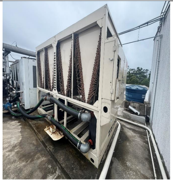
Chiller 01 - Em operação
