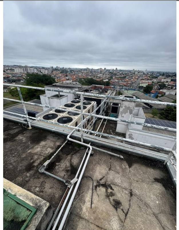
Vista superior – Área técnica
