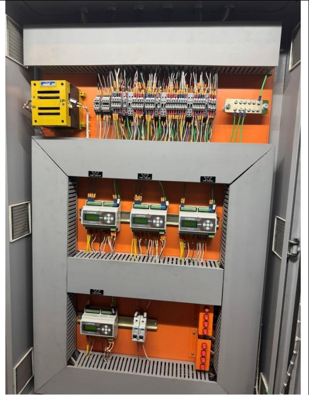
Painel de comando - Fan Coil
