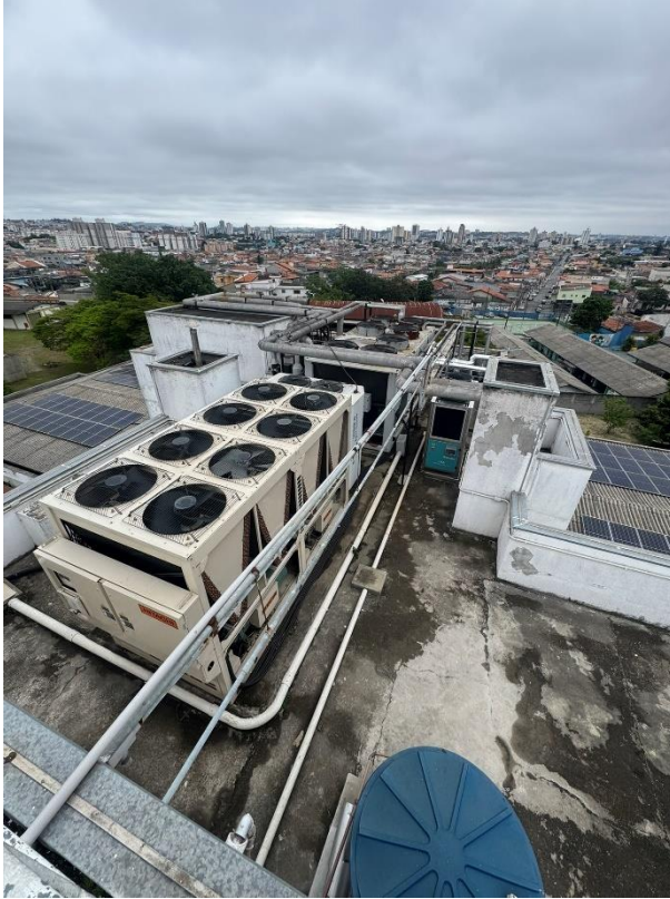
Vista superior – Área técnica
