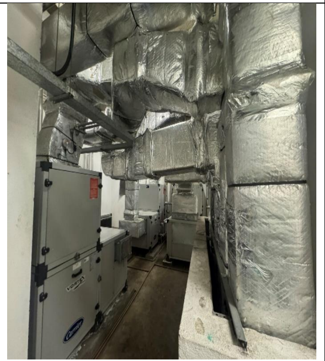
Casa de máquinas – Fan Coil
