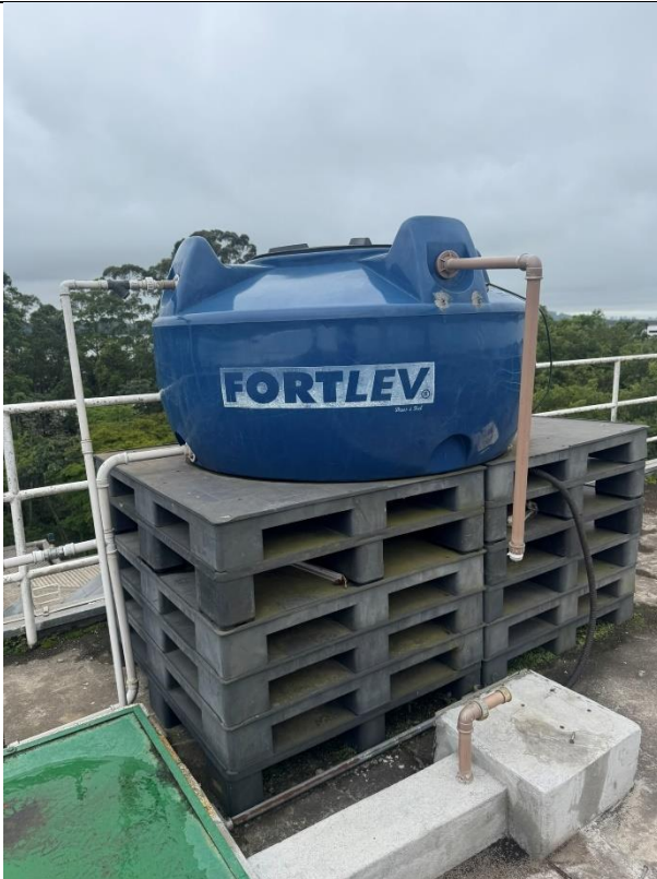
Reservatório secundário 02 – Chiller
