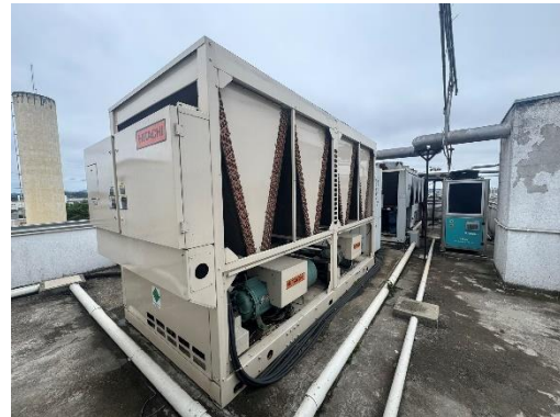
Fig - Chiller locado em operação (Hitachi)
