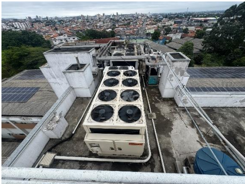
Fig - Vista superior dos Chillers a frente o Chiller alugado e atrás o Chiller desativado
