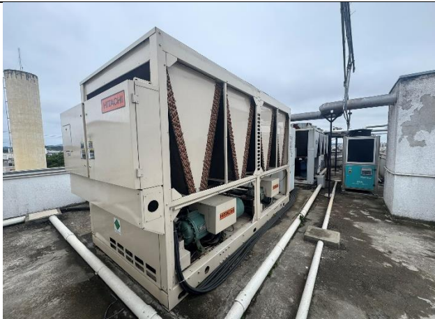
Chiller 01 - Em operação
