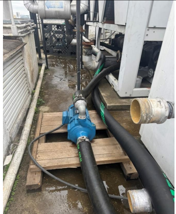
Bomba de água em operação
