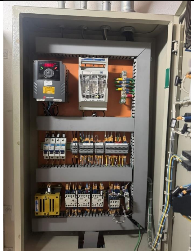
Painel de comando - Fan Coil
