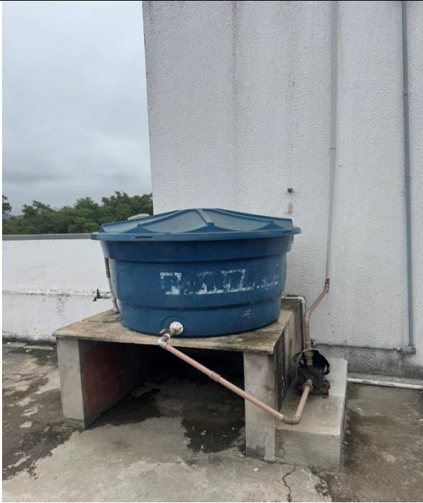
Reservatório secundário 01 – Chiller
