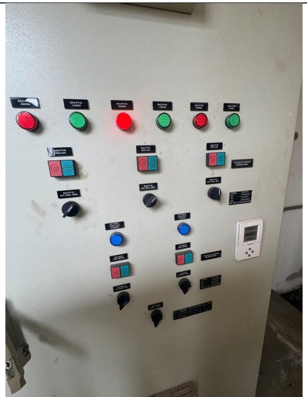
Painel de comando Chiller/Bombas
