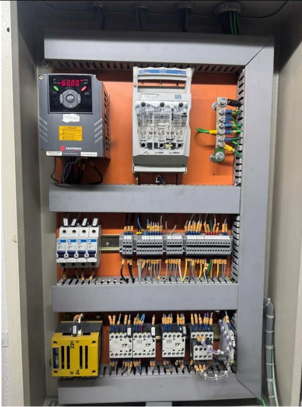
Painel de comando - Fan Coil
