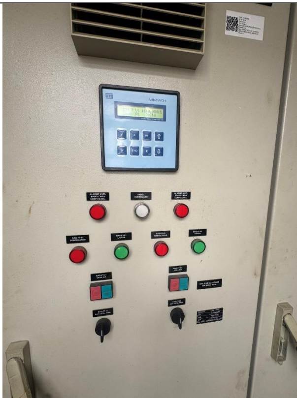
Painel de comando Chiller/Bombas
