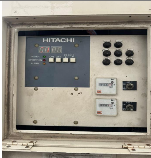
Painel de comando - Chiller
