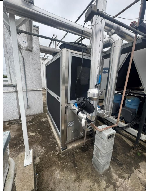
Chiller 03 – Em operação (Ressonância)
